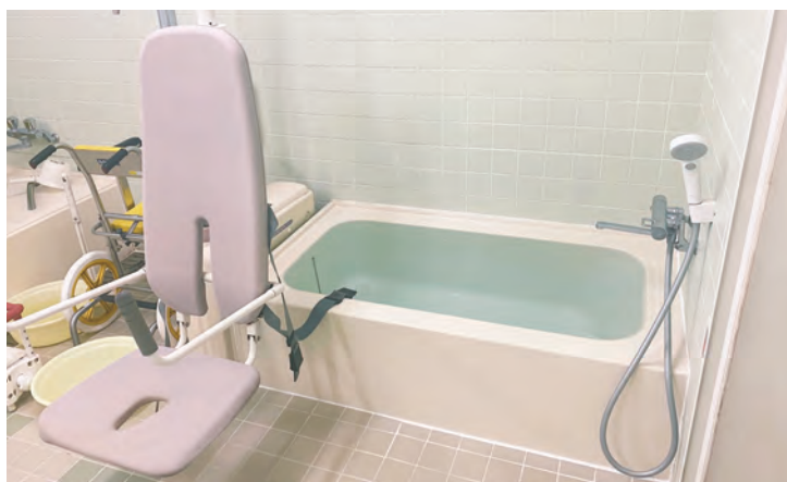
リフト付き個浴槽
